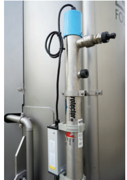
Bild 2: Optional ist die Anlage mit einer UV-Wasserbehandlung ausgestattet.
